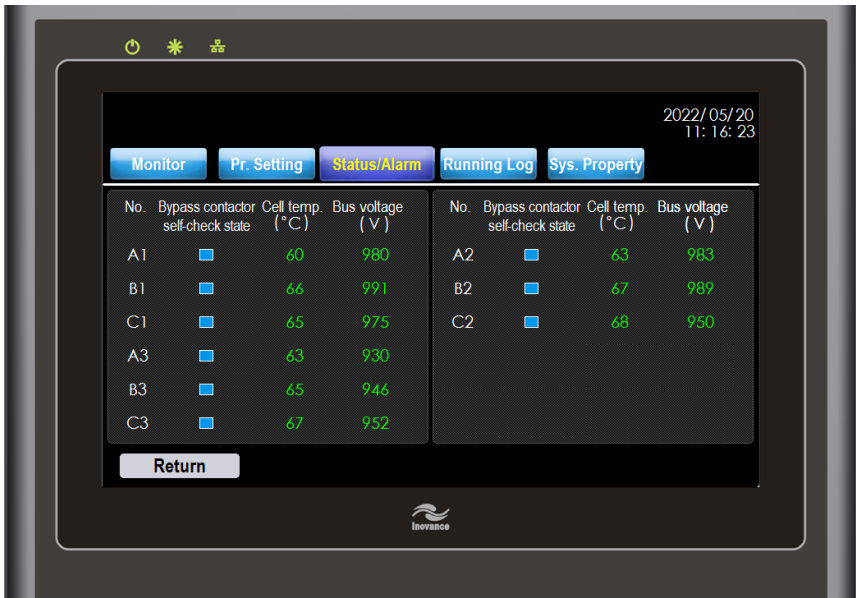
Рис. 5-21. Просмотр дополнительных данных о состоянии силовых ячеек
